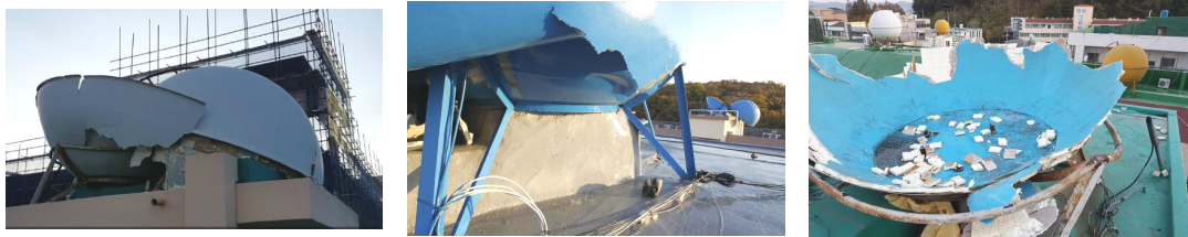
〈그림 1〉 경주 지진에 의해 파손된 물 저장탱크
